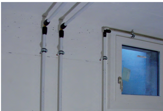
iFIT warm- en koudwaterinstallatie
