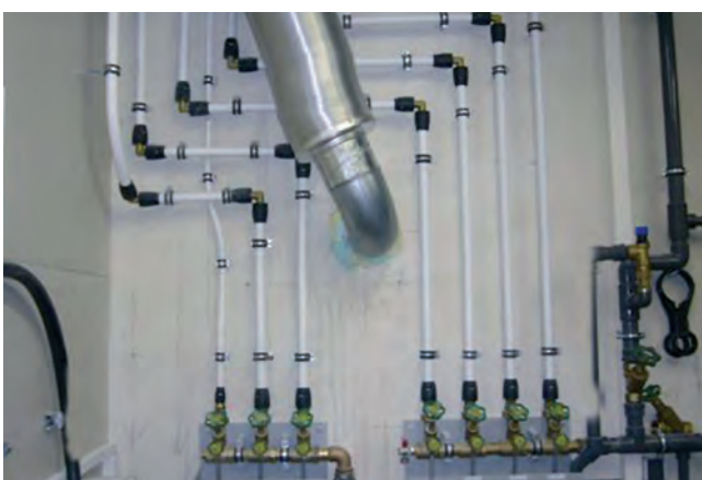
iFIT verwarmingsinstallatie, Spa Fitness Center
