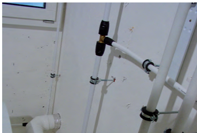
iFIT warm- en koudwaterinstallatie
