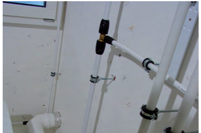
iFIT warm- en koudwaterinstallatie
