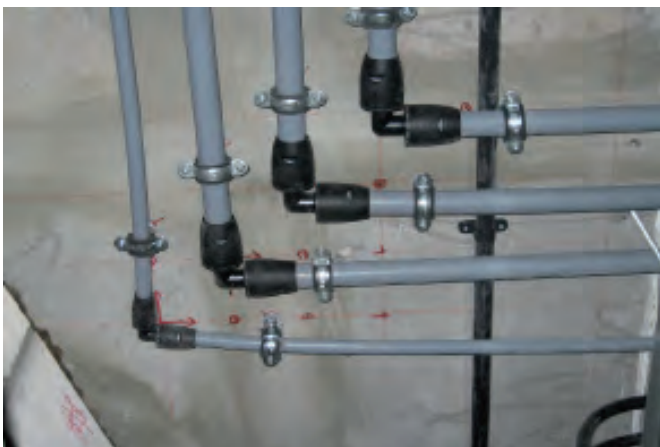
iFIT, warm- en koudwaterinstallaties in het midden Oosten
