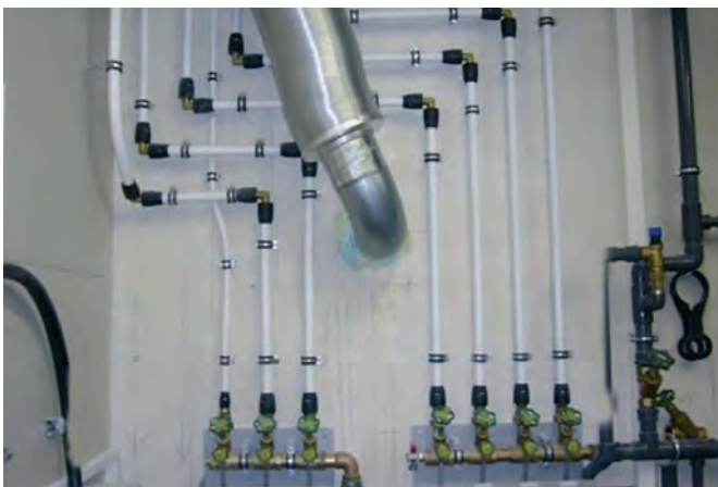
iFIT verwarmingsinstallatie, Spa Fitness Center
