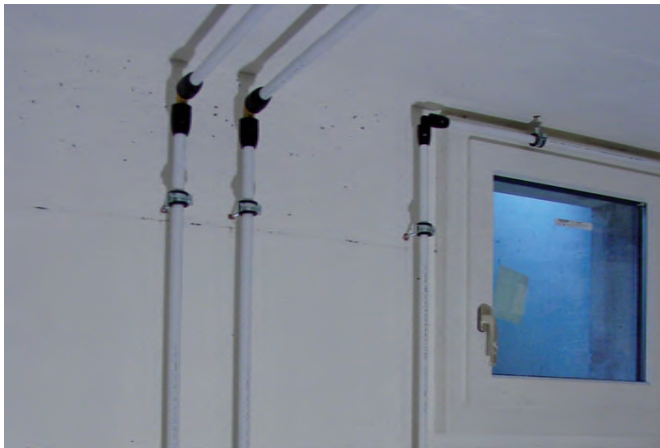
iFIT warm- en koudwaterinstallatie
